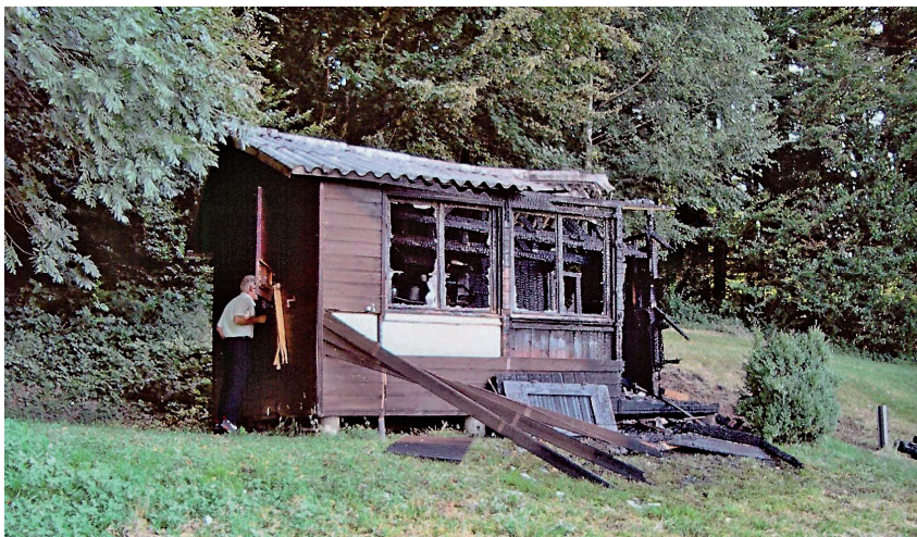
Hüttli nach dem Brand September 2004
